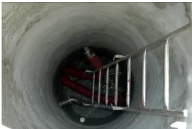
Fotografía 6. Conjunto de tuberías, independientes, para la conducción del agua a la Planta de Envasado.
